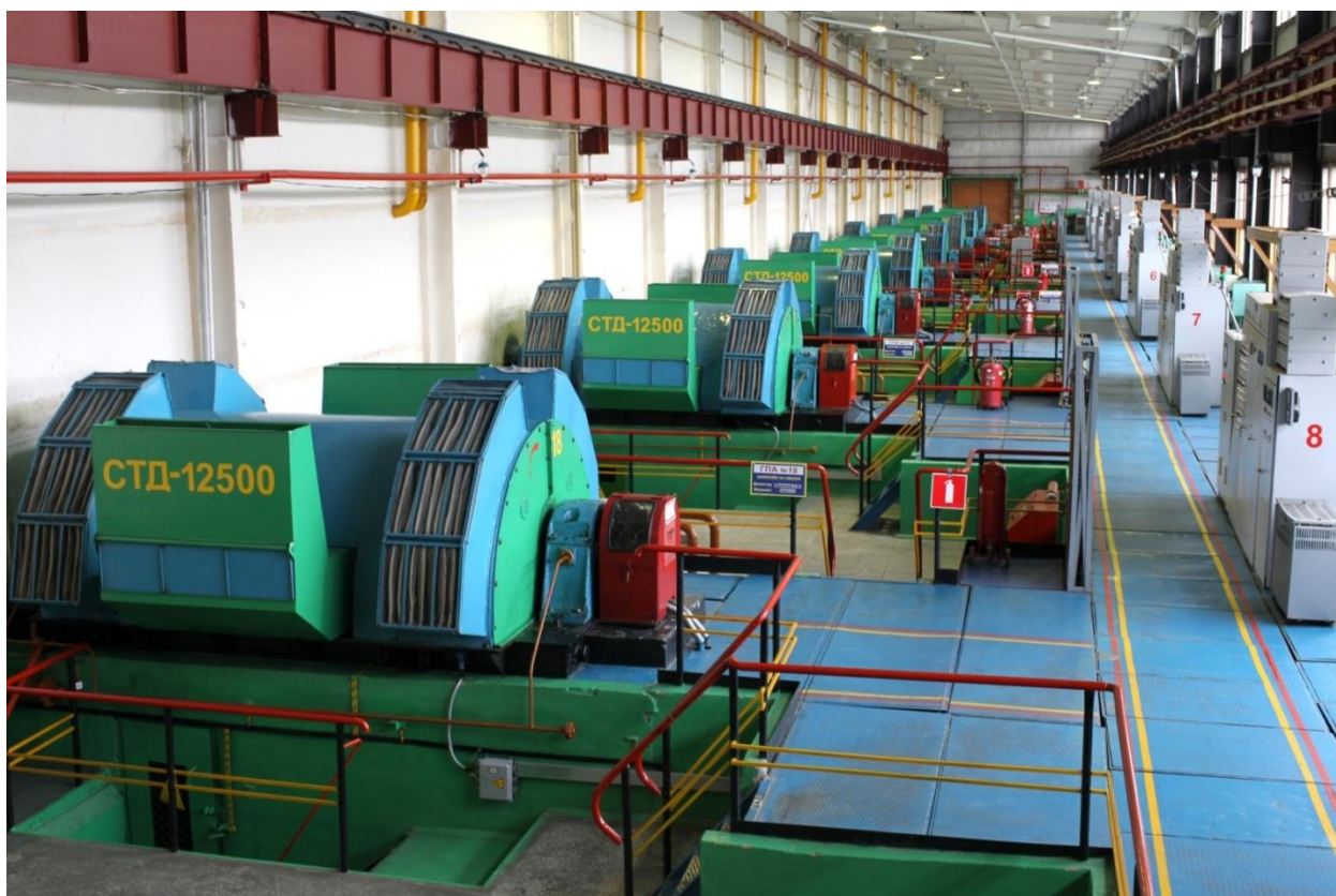
Рис. 1.5. Общий вид компрессорной станции с приводными двигателями СТД-12500.
